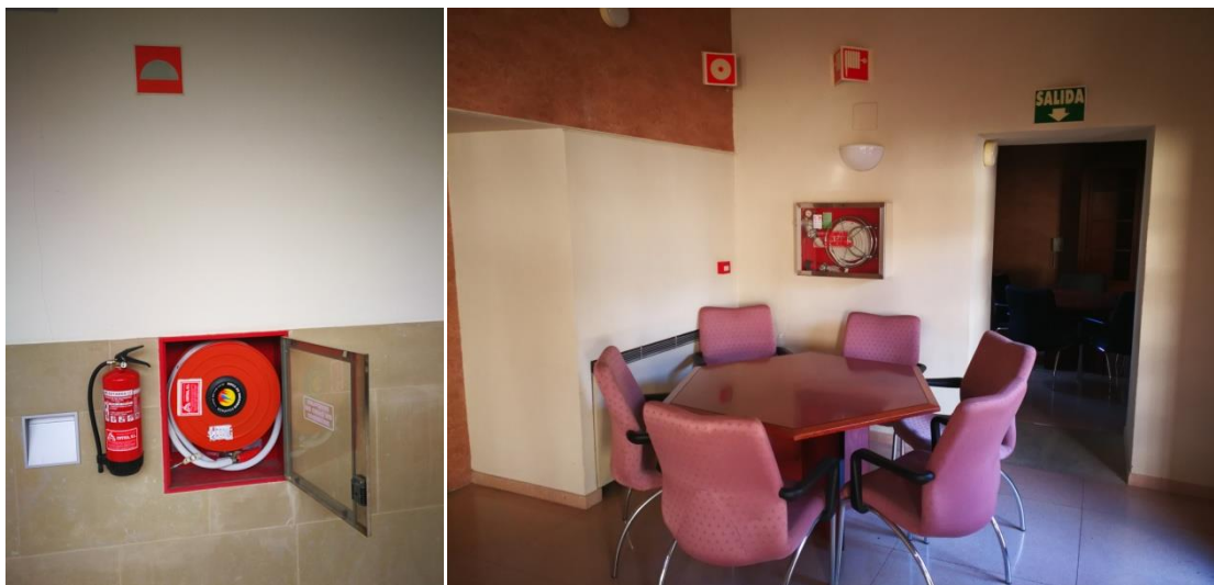
Dos tipos de BIE's hay instalados en los edificios: semirrígidas de 25 mm y flexibles de 45 mm.
