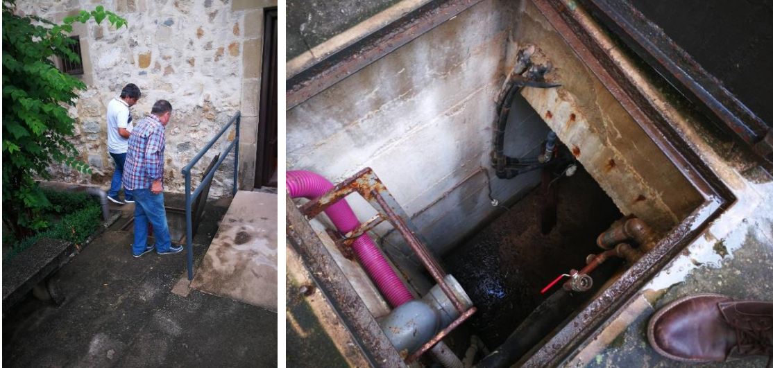
El acceso al grupo de bombeo se realiza a través de una arqueta.
